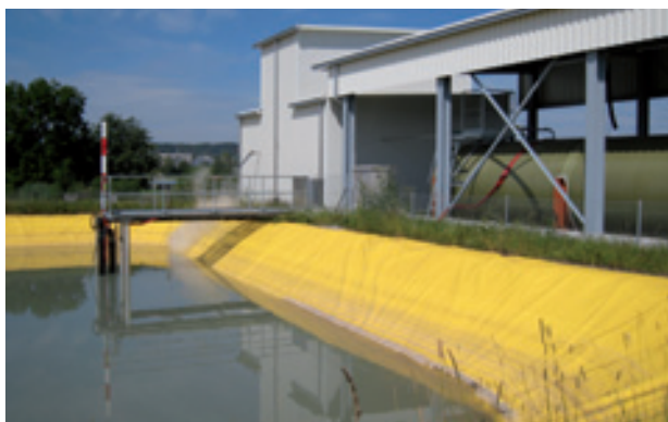
Stapelbecken für stark belastetes Enteiserabwasser, Gebäude der Destillationseinheit, Tank für gewonnenes Konzentrat
